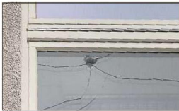
Zwei Fensterscheiben wurden vermutlich mit Steinen zerstört.
