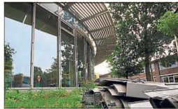
An der Mensa wurden Jalousien aus der Führung gerissen.
